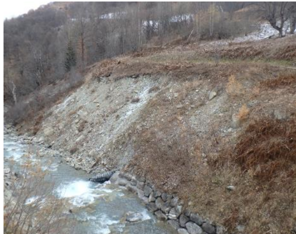
Figure 15 : affouillement en rive droite de la Valloirette au droit du périmètre d'étude
